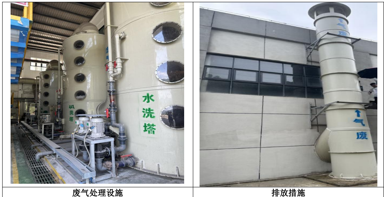
图 4-2 废气处理措施
