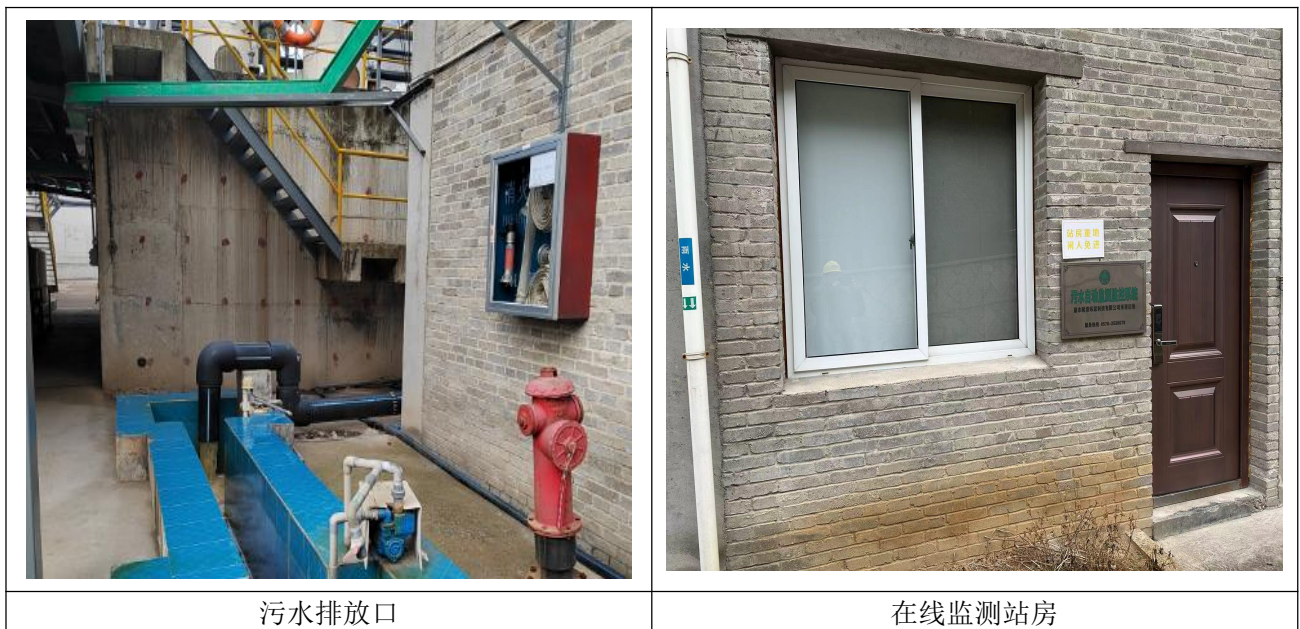
图 5-6 排放口及在线监控情况
