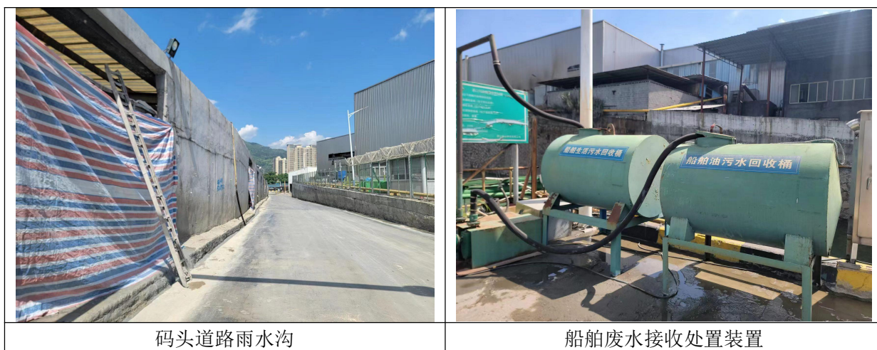
图 5-1 污水处理、收纳装置现场图
