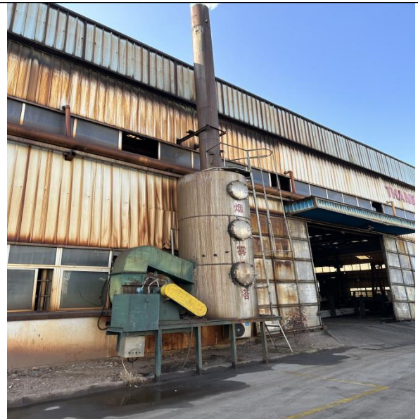
固熔炉喷淋塔
