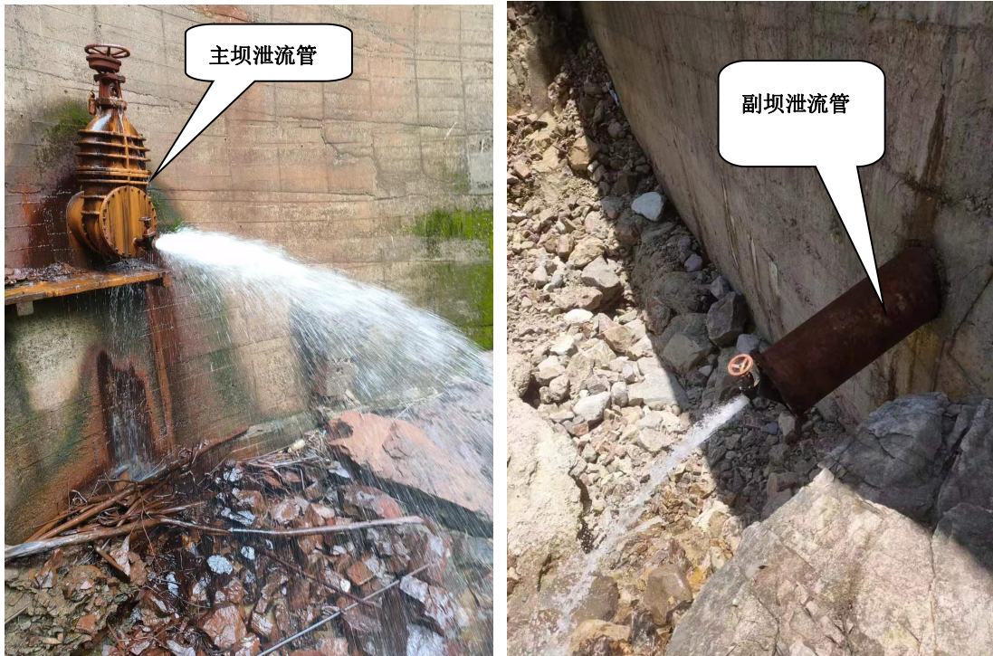
图 4-1 泄流管现场图
