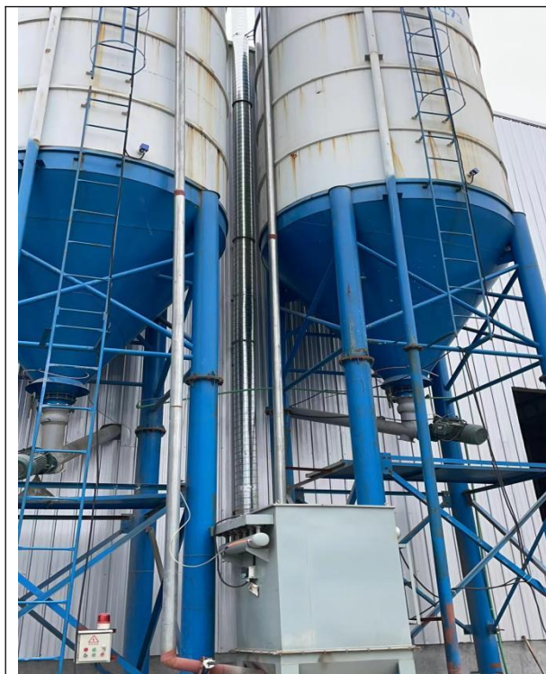
筒仓和除尘器
