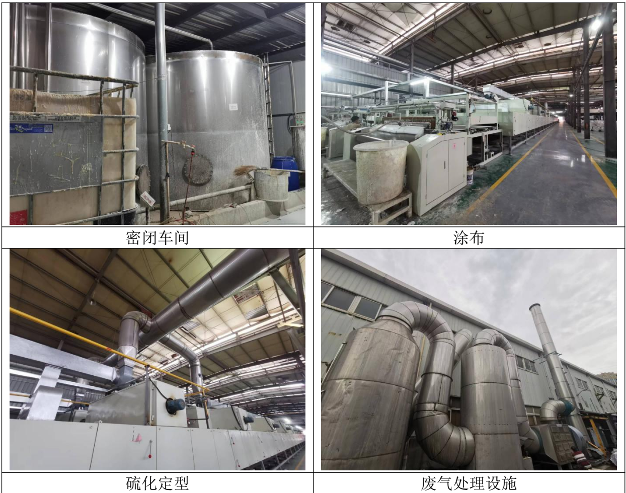
图 3-1 项目废气产污结点和处理设施现场图
