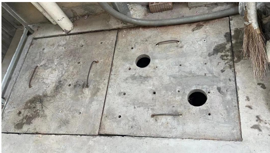
图 3-1 污水沉淀池现场图
