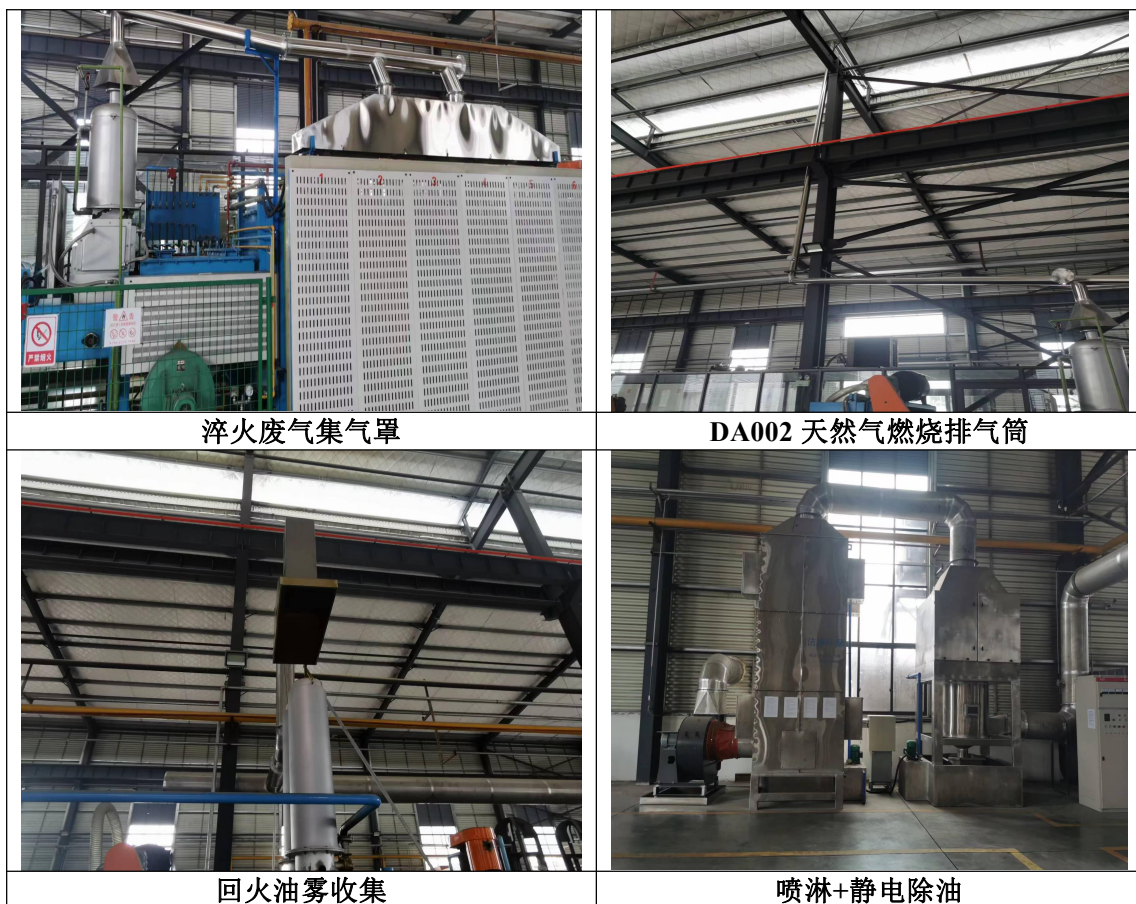
图 5-4 热处理线产污节点和处理设施现场图
