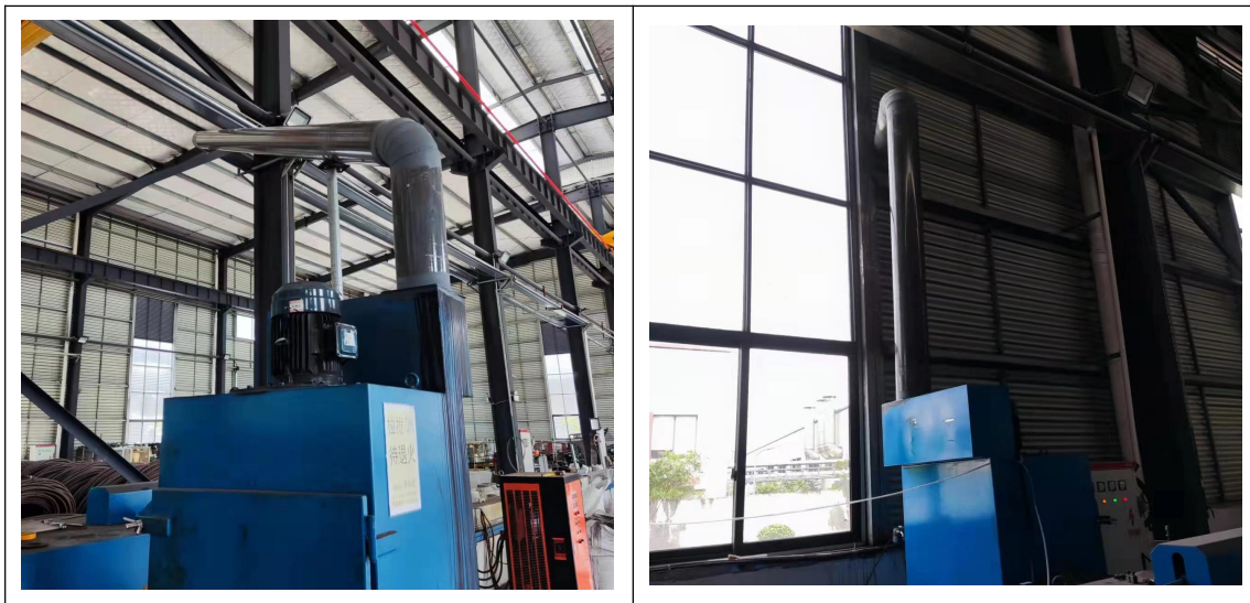
图 5-6 除锈线除尘器
