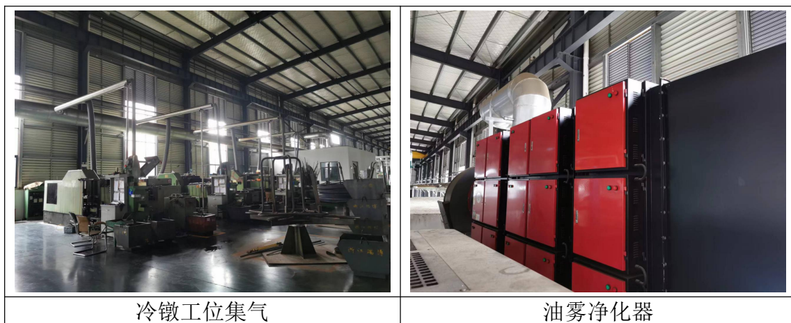
图 5-5 冷镦废气产污节点和处理设施现场图
