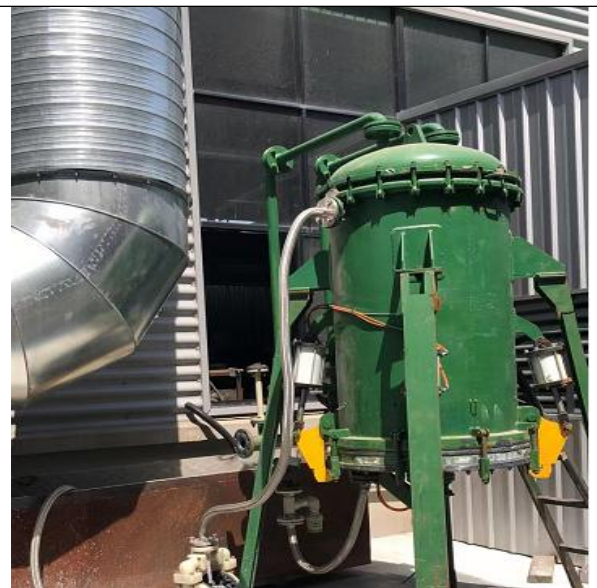
喷砂废水过滤器
