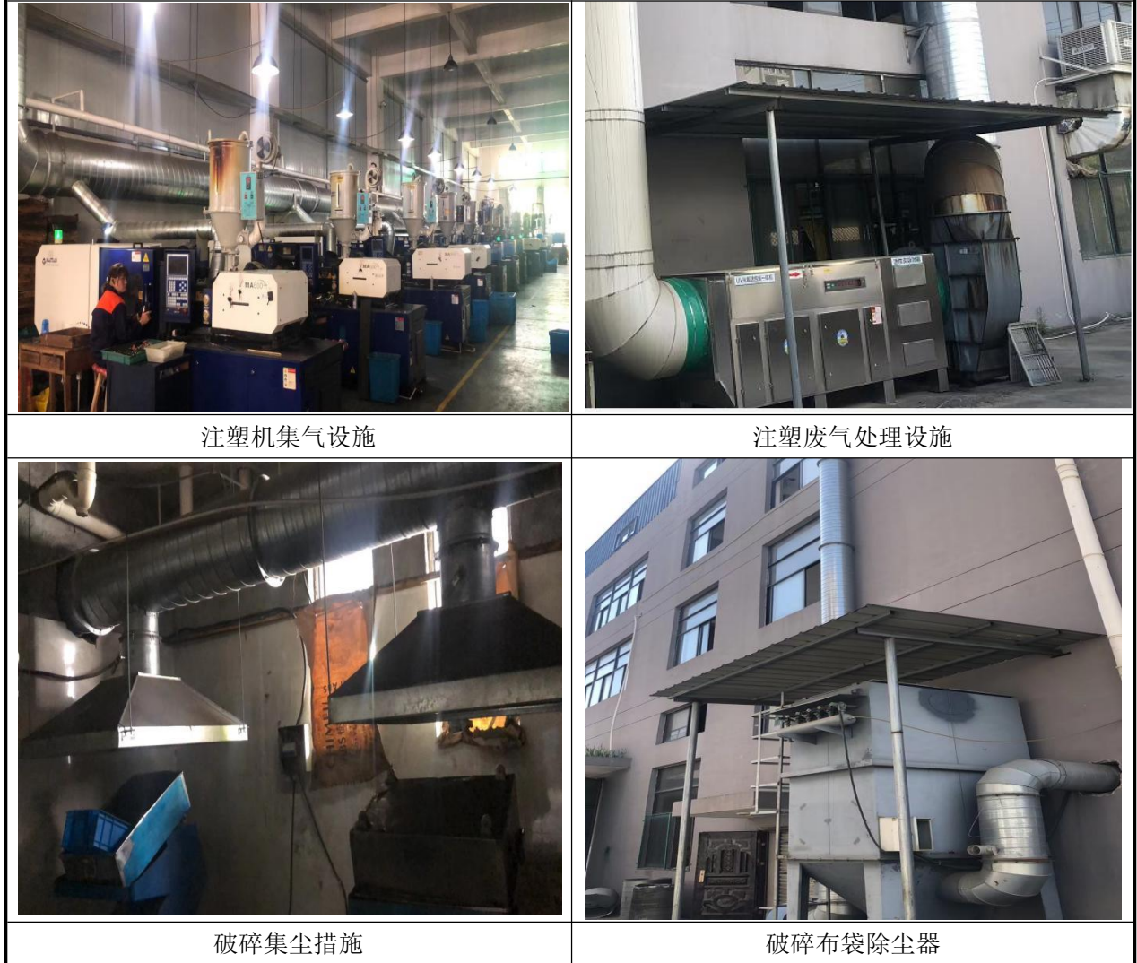
图 4-2 项目废气防治措施
