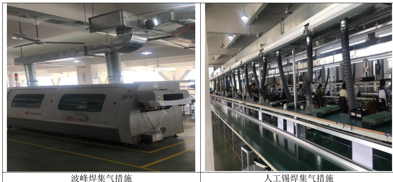
图 4-1 项目废气收集防治措施
