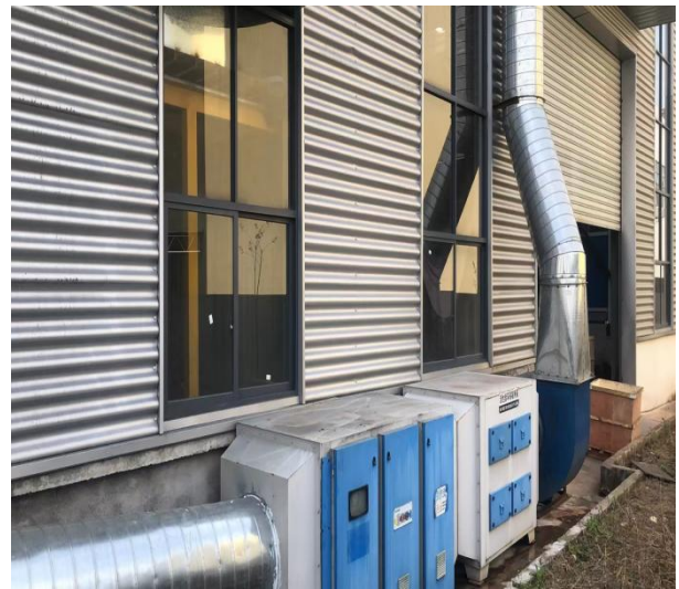
喷漆废气处理设施
