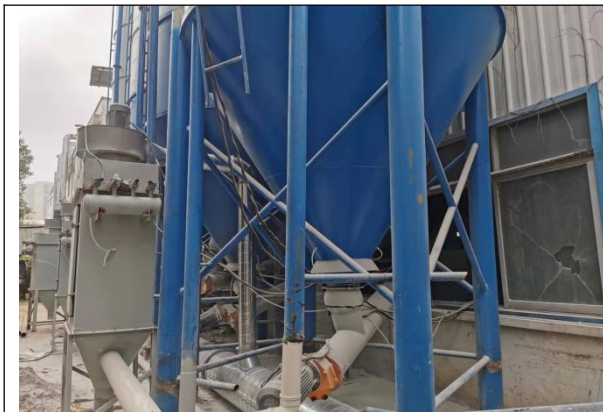
粉料罐除尘器
