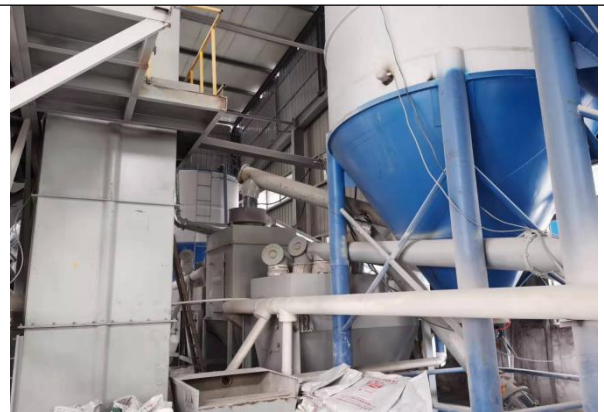
粉料罐除尘器
