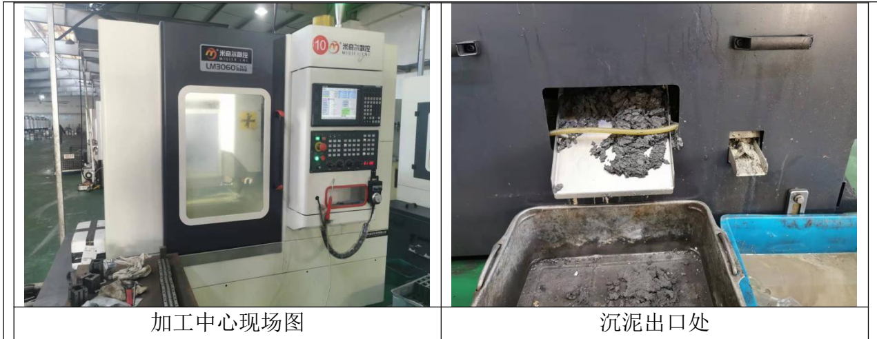
图 3-1 产污节点设施现场图
