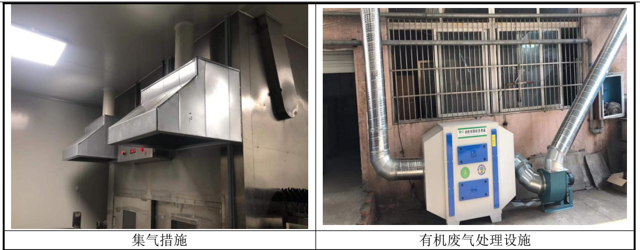
图 4-2 项目废气治理情况
