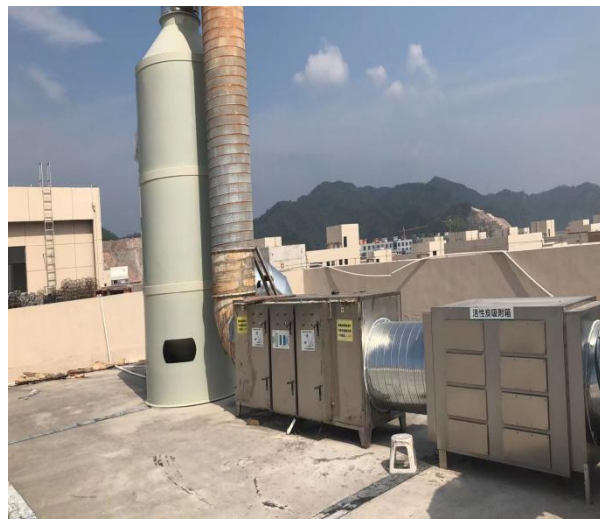
喷漆废气处理设施
