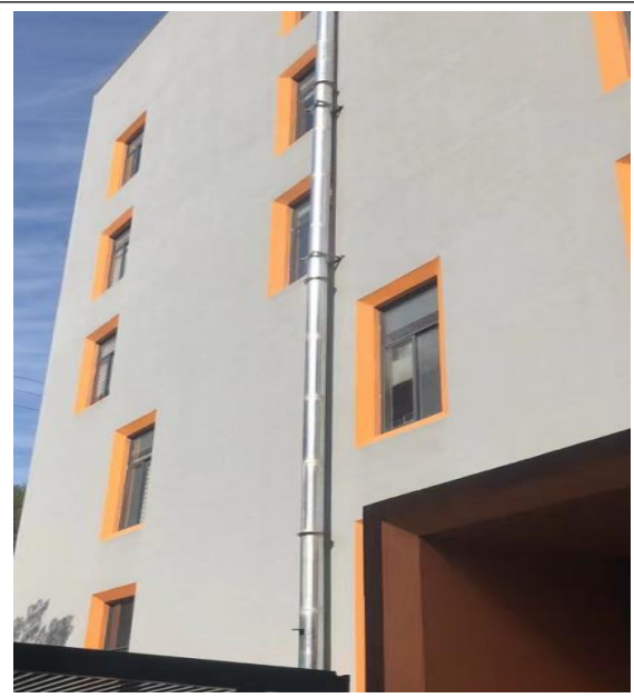
大型混料粉尘排气筒
