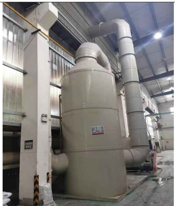
酸雾碱雾喷淋塔
