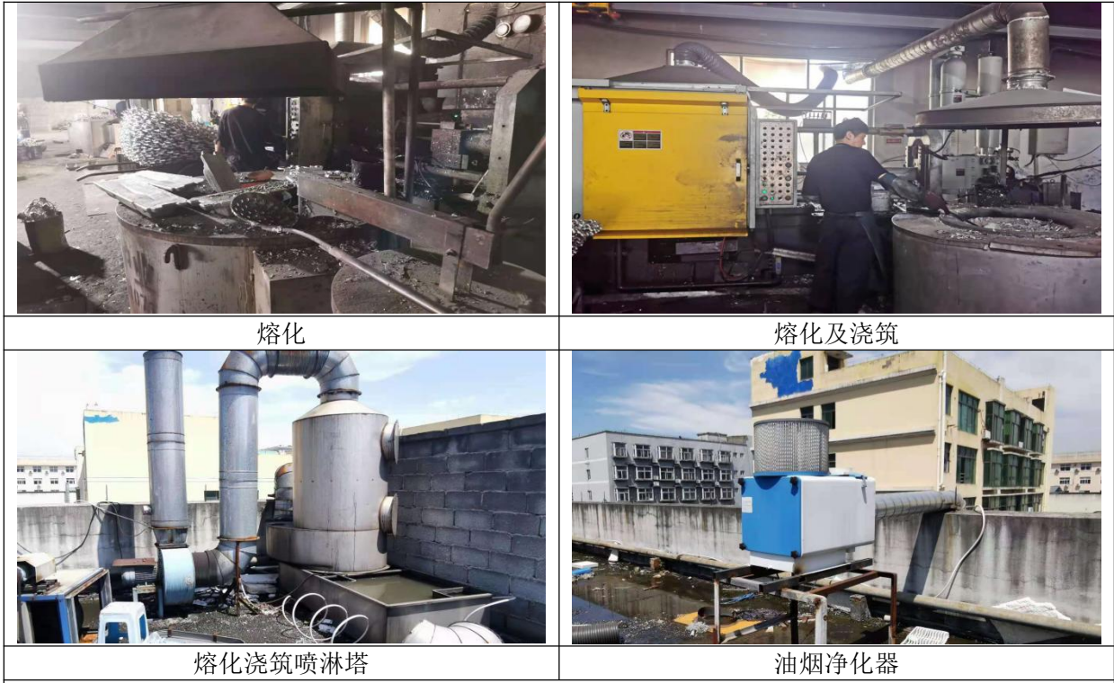
图 3-1 熔化浇筑脱模废气产污及处理现场图
