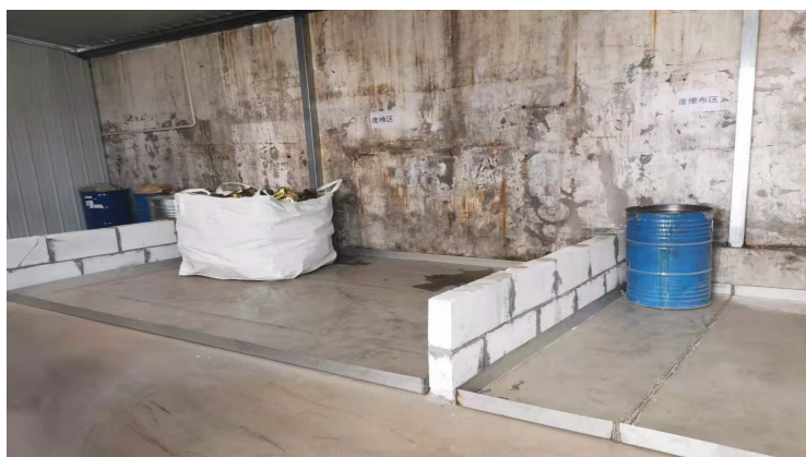
图 5-4 精馏残渣危废仓库现场图
