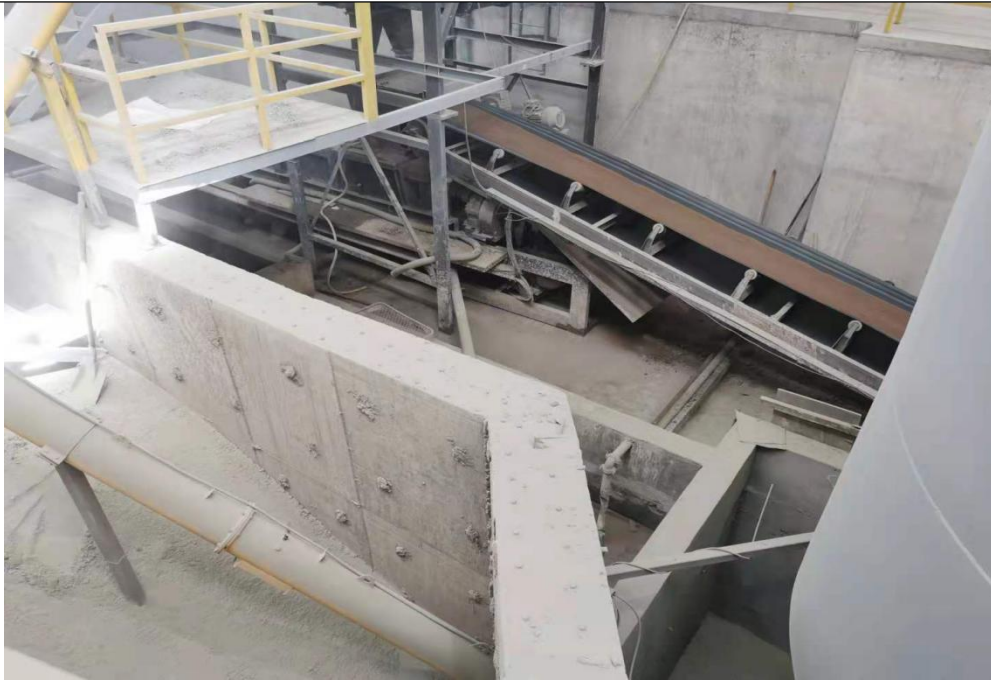
图 3-2 水稳车间部分收集沉淀水池及生产线现场图
