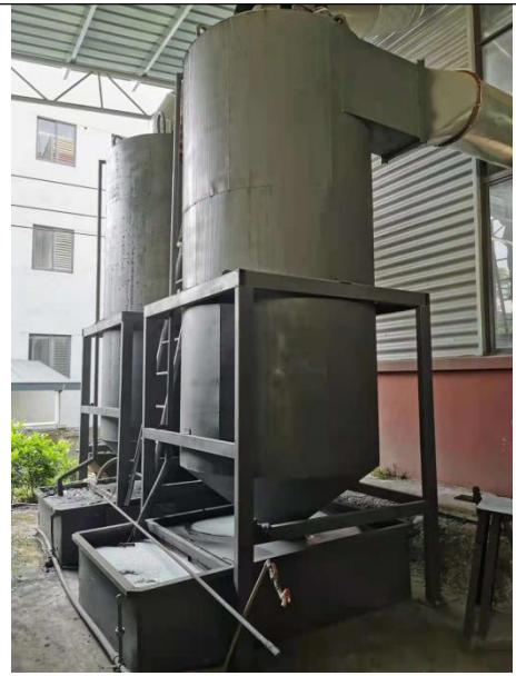
喷淋设施现场图
