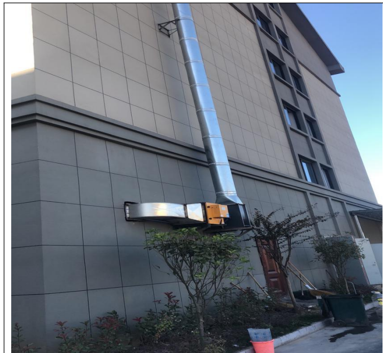
项目油烟净化器、排放高度: 至4楼楼顶
