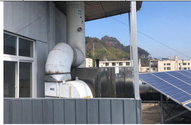
楼顶废气处理设施
