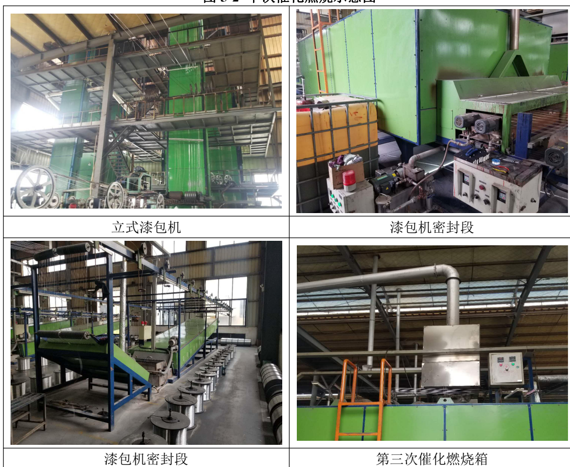
图 5-1 废气处理现场图
