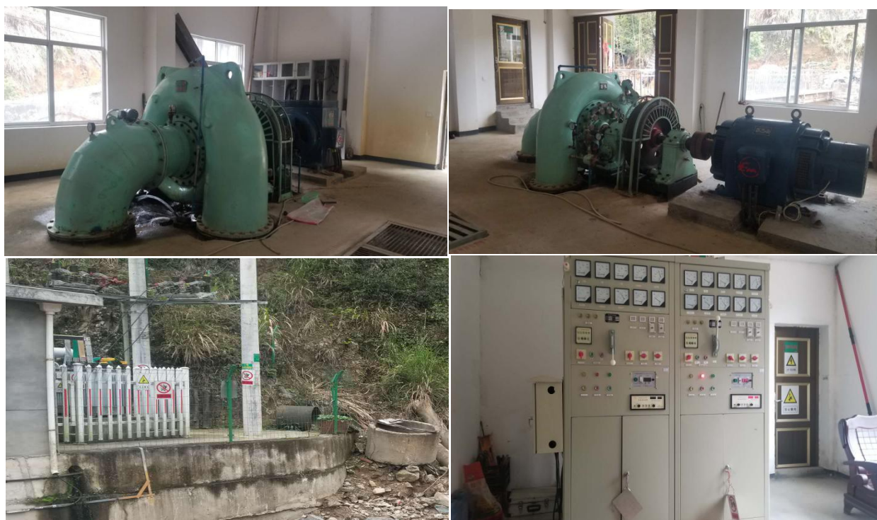
图 3-2 发电厂房现场图
