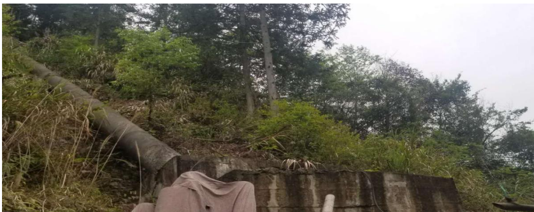
图 9-5 压力钢管现场图
