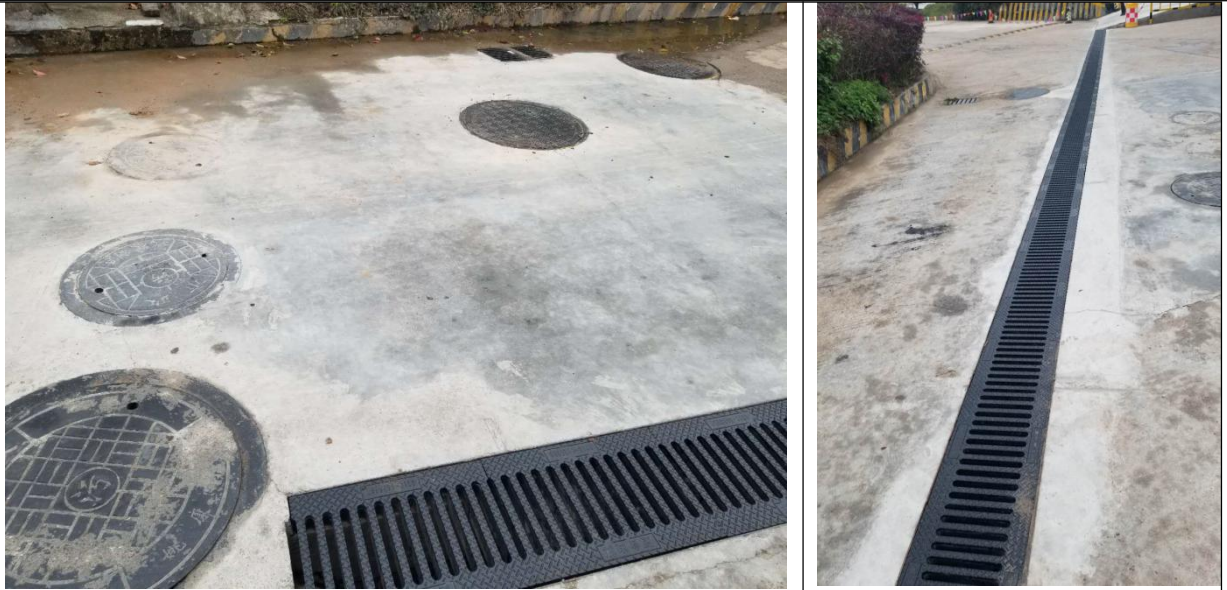
图 4-2 项目雨水收集池隔油池现场图
