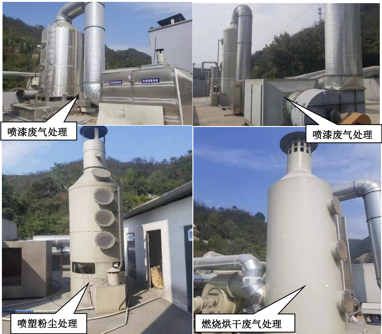
图 4-3 废气处理设施现场图
