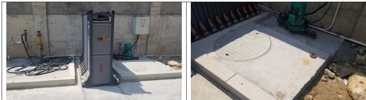
图 4-2 雨水收集沉淀池现场图
