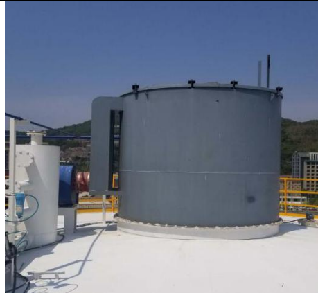
均化筒库排气口
