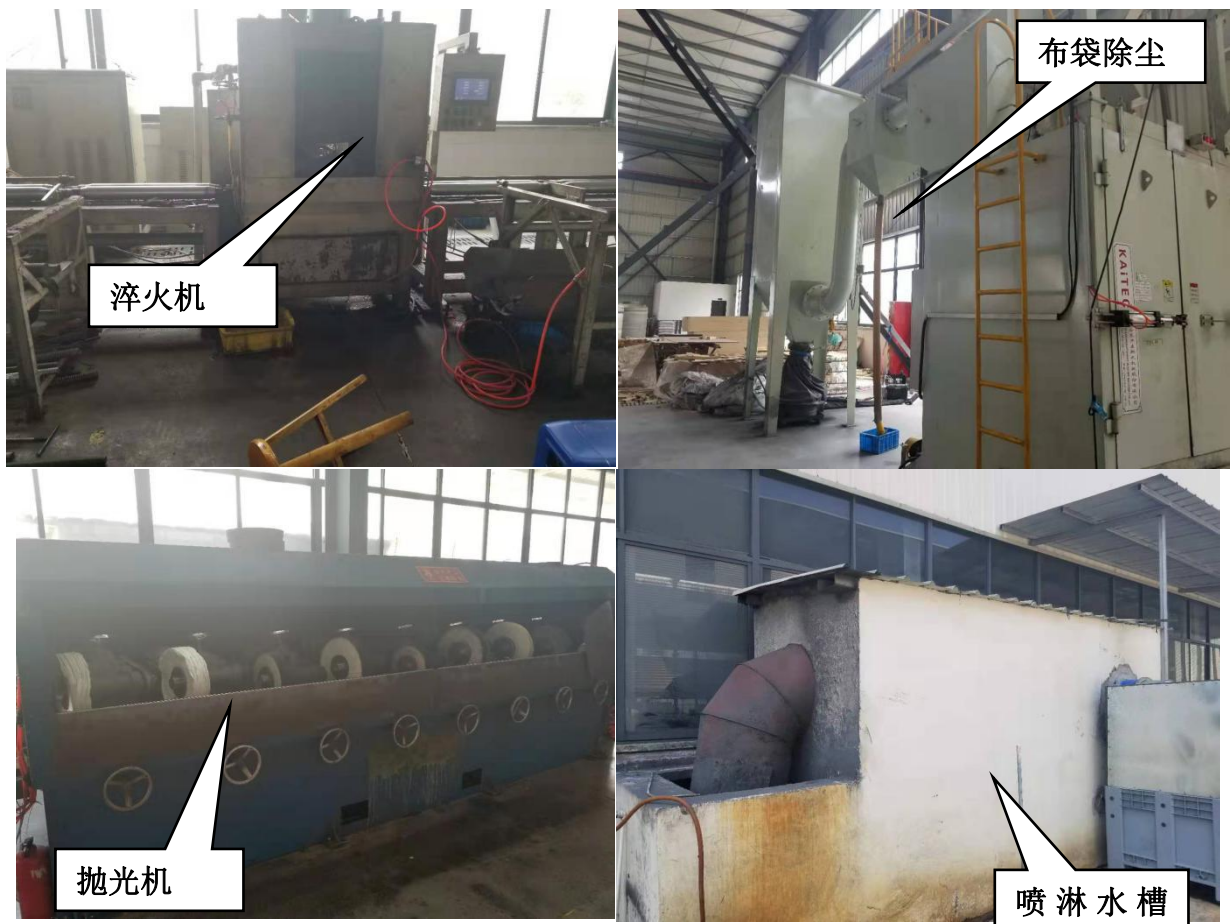
图 4-2 废气处理设施现场图
