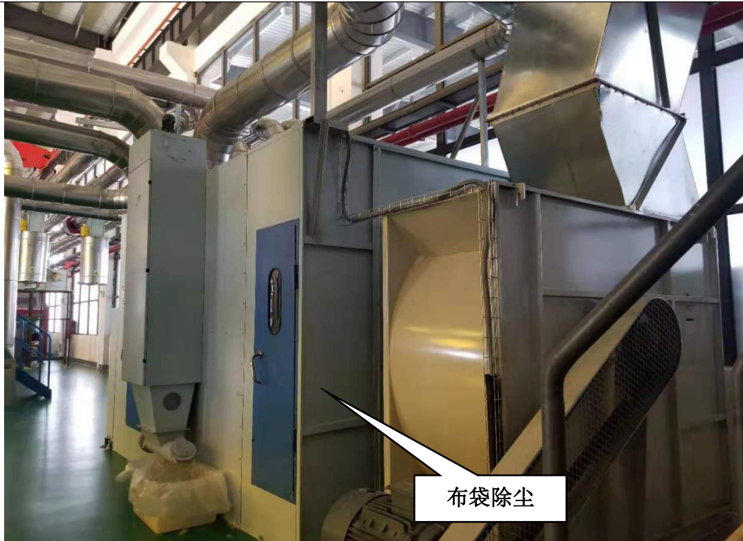
图 4-2 开松设备及其废气处理设施现场图
