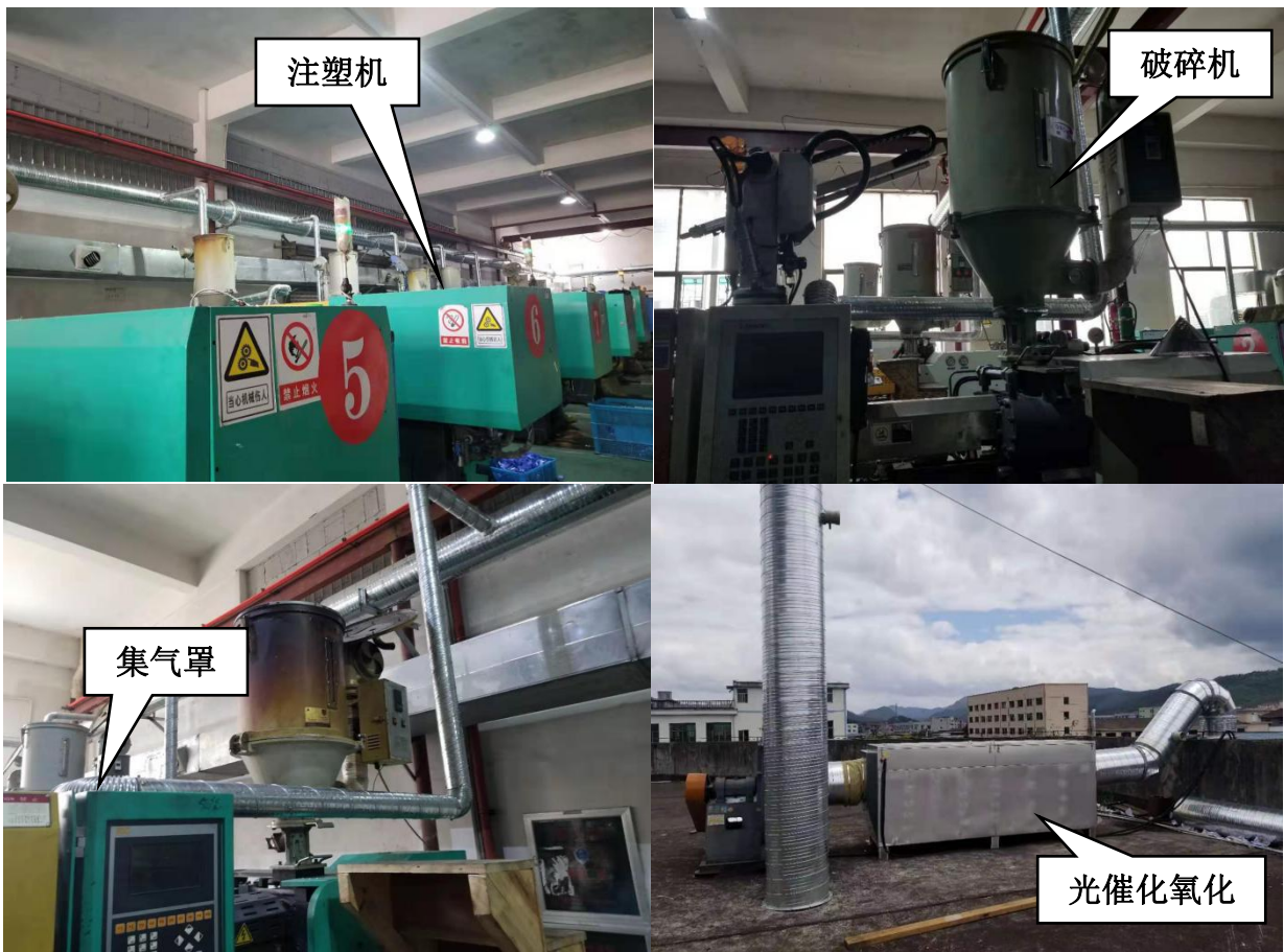
图 4-3 注塑废气处理现场图
