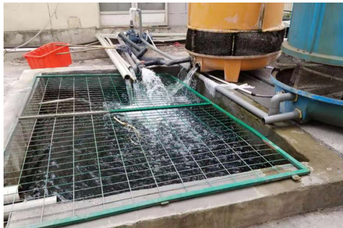
图 4-2 冷却水池现场图
