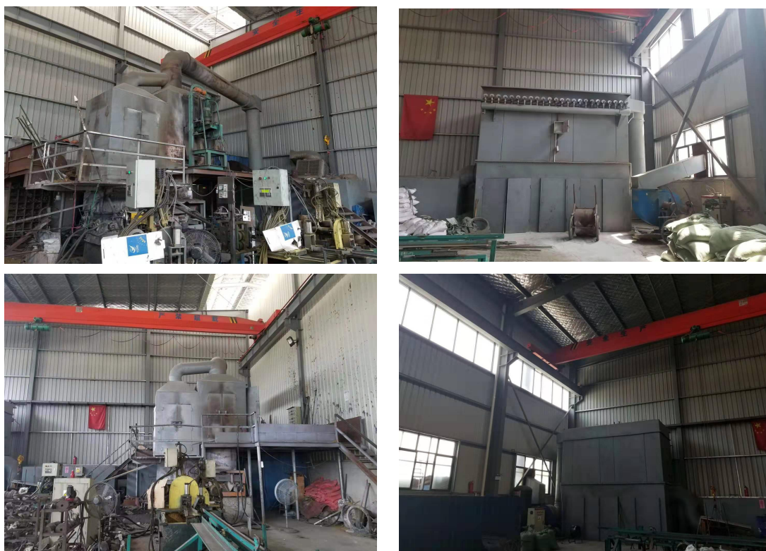
图 5-1 熔炼炉废气一体化设备现场图
