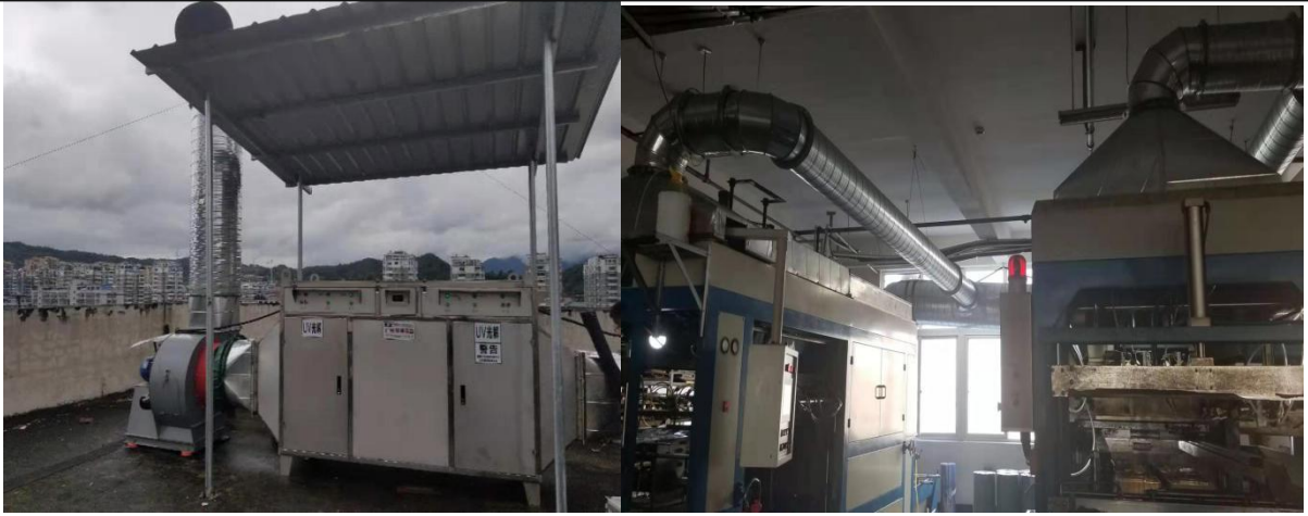
图 4-3 废气处理设施现场图
