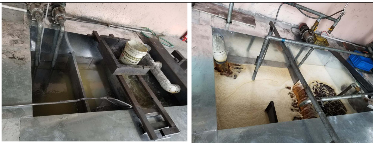
图 4-2 循环池现场图
