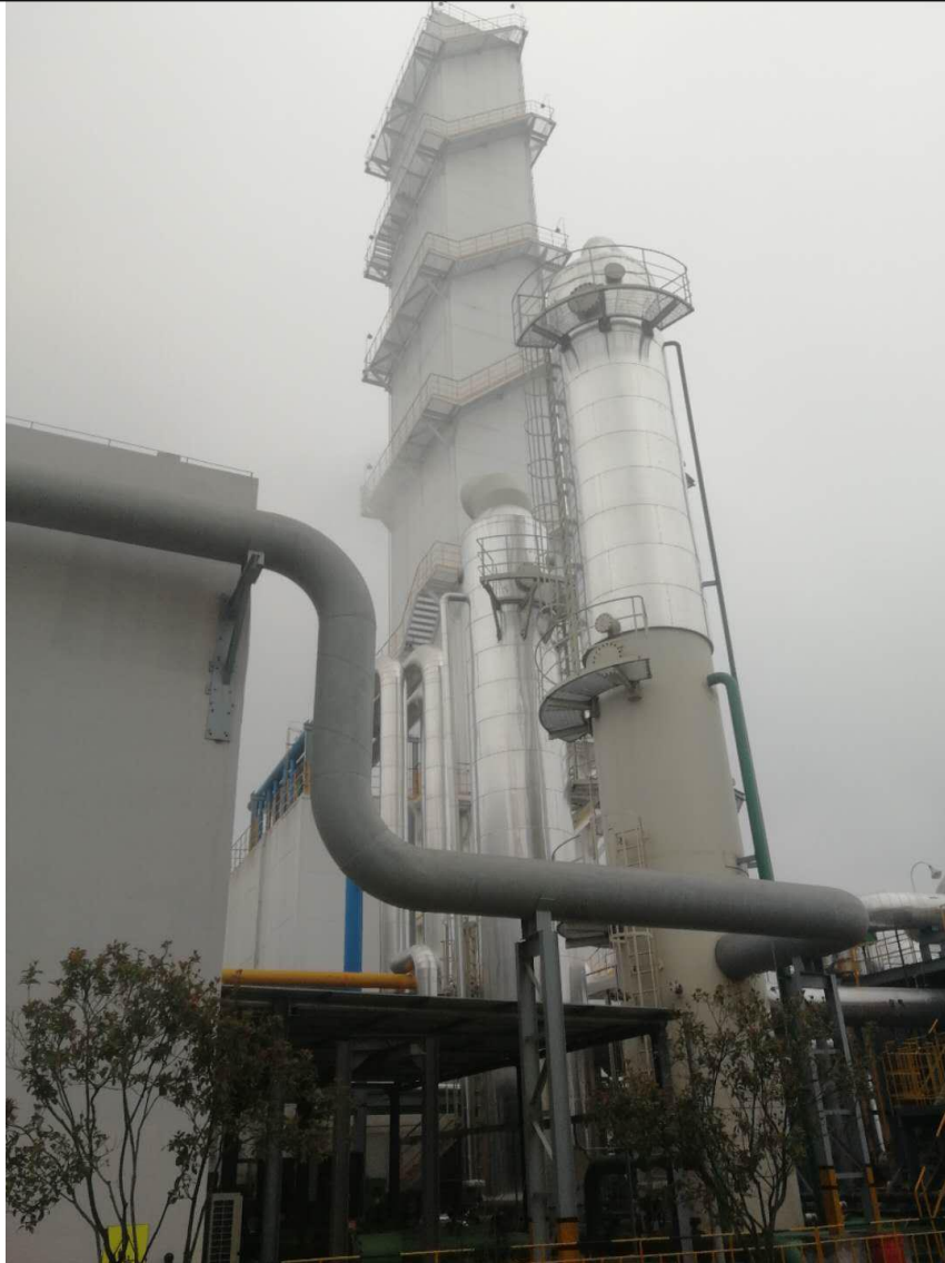
图 4-3 排气筒现场图
