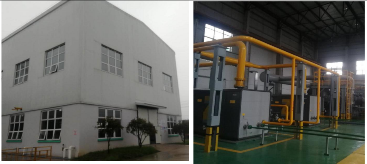
图 4-4 压缩机房现场图
