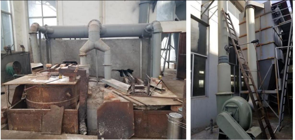
图 4-2 盐浴炉+旋风布袋除尘器现场图
