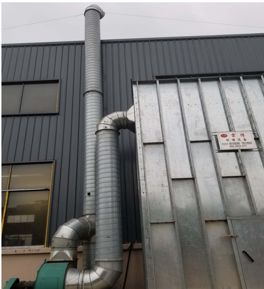
图 5-4 木加工粉尘处理设施+4#排气筒现场图
