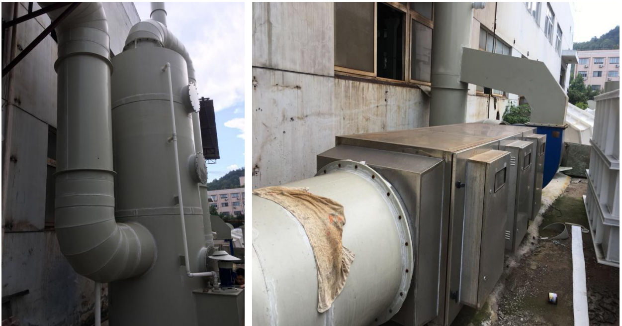
图 3-3 废气治理设施图
