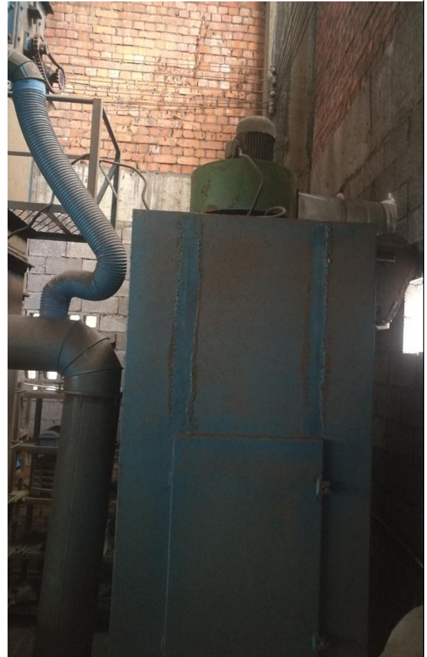
抛丸粉尘治理设施现场照片
