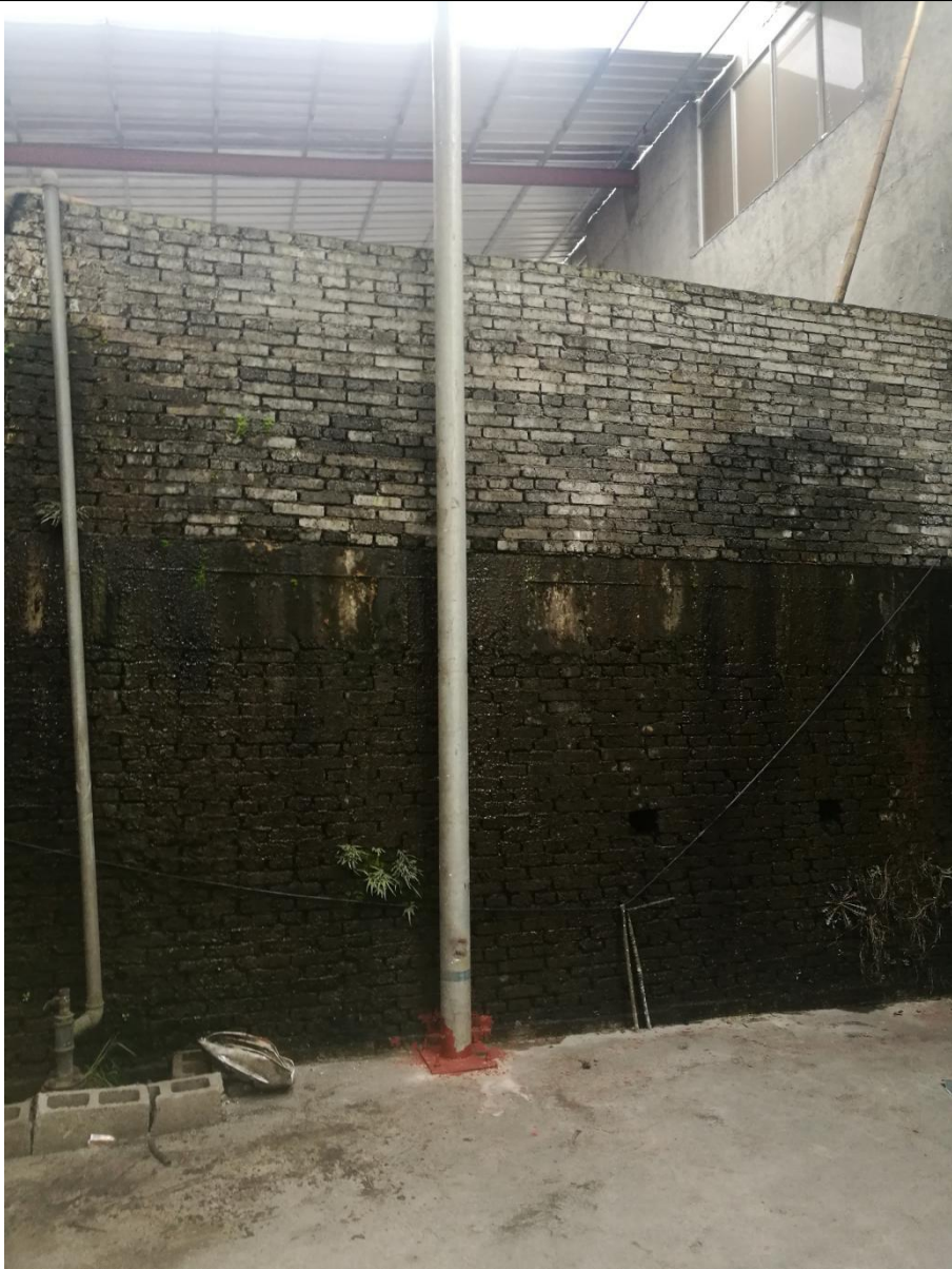
图 4-2 冷却水池现场图
